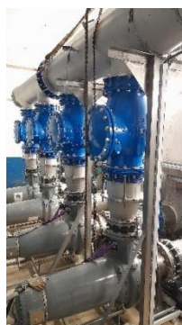
Poste de relevage Vauban - ANTIBES : Réalisation de l'Enceinte étanche du nouveau local technique et installation des quatre nouvelles lignes de pompage
